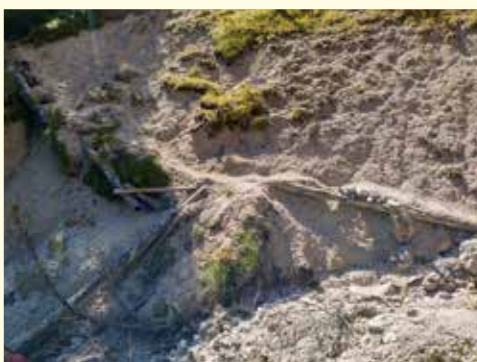
Vor dem Reparieren
